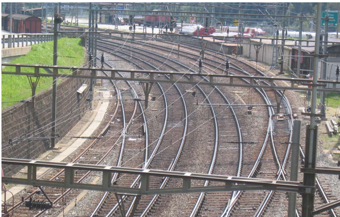
III. 10: Malgré son fort dénivelé et des virages étroits la ligne du Gothard est très performante et son équipement (installations de sécurité etc.) correspondent à l'état de l'art. Portail sud du tunnel de faîte à Airolo.
